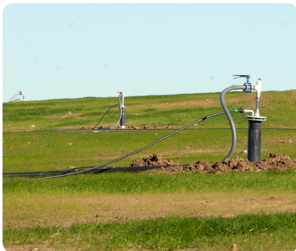
Cabezal de pozo de extracción de biogás (2012)
