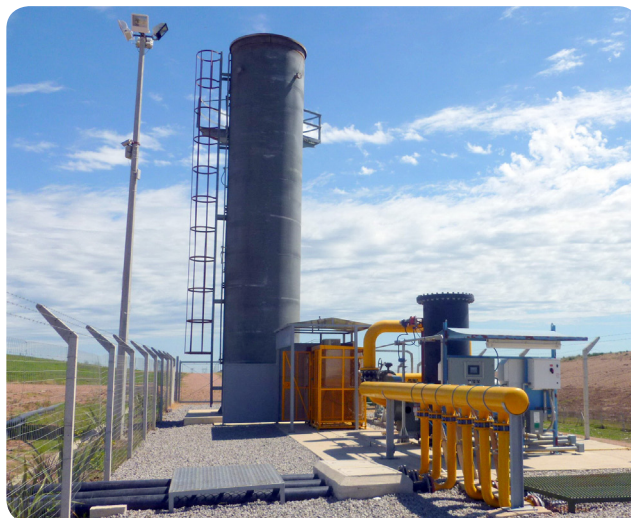
Instalaciones de la planta de captura y quema de biogás (2012)
