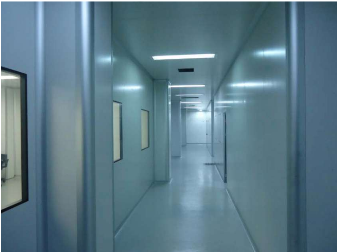
Foto. Ej. Sistema GMP de Panelería aplicado en un bloque de salas farmacéuticas.
